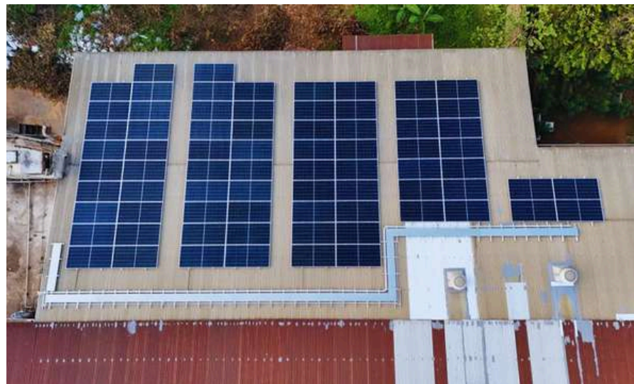
Gunung Putri, Jawa Barat Capacity: 42.55 kWp
