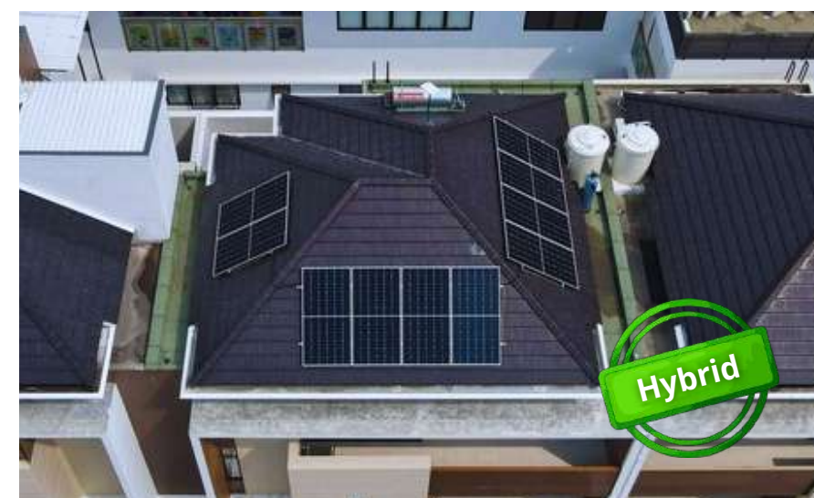
Bekasi, Jawa Barat Capacity: 5.5 kWp
