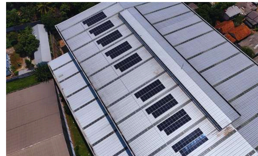
Gunung Putri, Jawa Barat Capacity: 106.03 kWp
